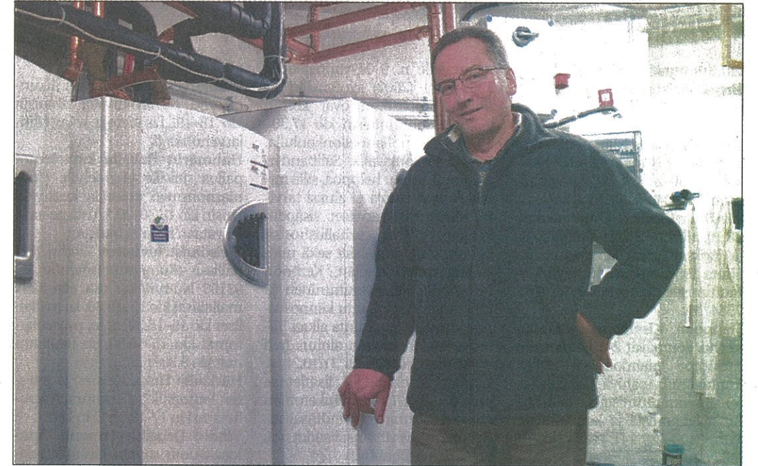
Tyytyväinen maalämpölämmittäjä. Juha Kiviniemi päätyi parisen vuotta sitten vanhassa liiketalossa vaihtamaan öljyllä lämmittämisen maalämmöllä lämmittämiseen - eikä ole hetkeäkään katunut. Investointi maksaa itsensä näillä näkymin etuajassa.
